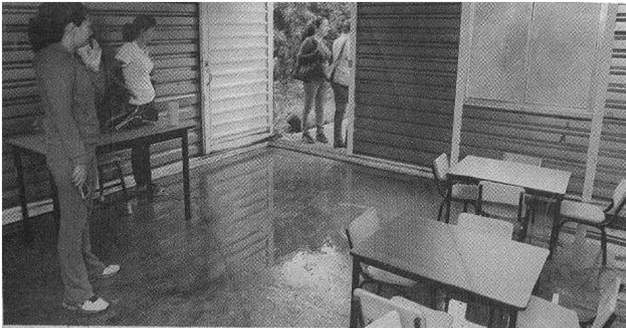
DEFICIENCIAS. La noche del domingo la lluvia se filtró a los salones nuevos, con lo que quedaron mojados piso, mesas y sillas
