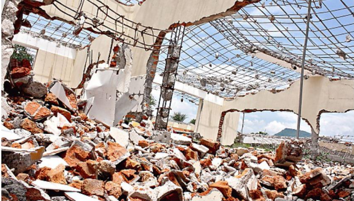
SIN AULAS. De las escuelas que existían en La Nueva Jerusalén solamente quedan ruinas; religiosos las destruyeron el pasado 6 de julio.
