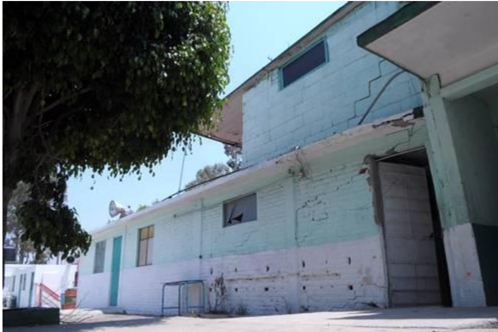
Los daños en el escuela República de Madagascar
