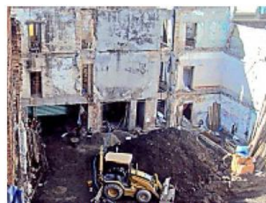
> La construcción de una obra en la calle de Colombia 22 provocó la afectación a la escuela.
