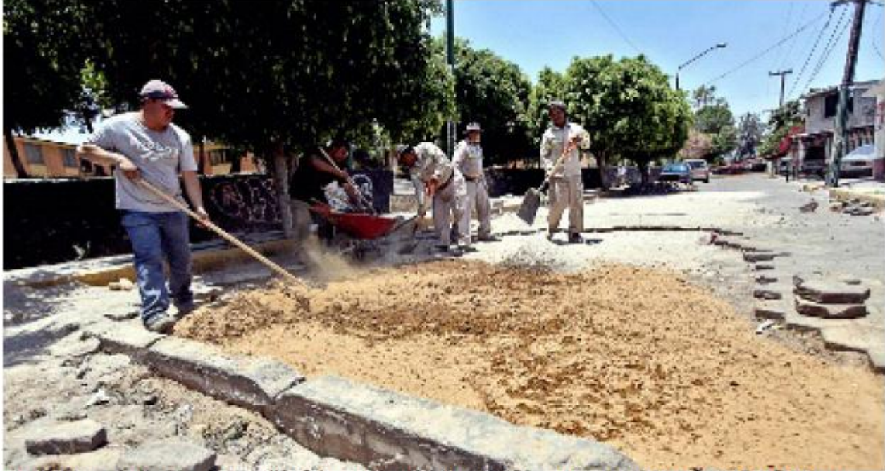
► Las grietas en el subsuelo rompieron el pavimento en la calle Primer Retorno Norte y Batalla 5 de Mayo, en la Colonia Ejército de Oriente. Los trabajadores aseguran que el nuevo asfalto sólo dura 3 o 5 meses.
