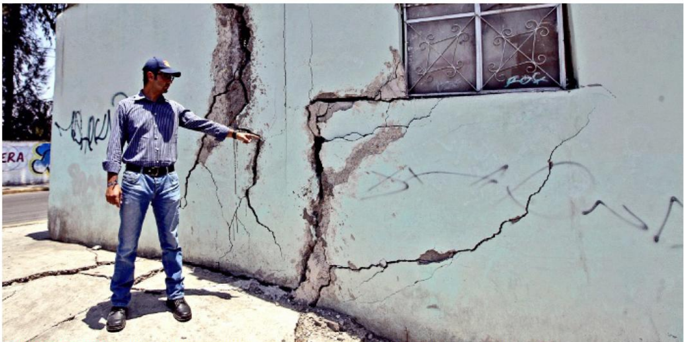
PELIGRO LATENTE. El geólogo Raúl Gutiérrez muestra las afectaciones mayores a una vivienda ubicada en la Colonia San Sebastián Tecoloxtitlan.
