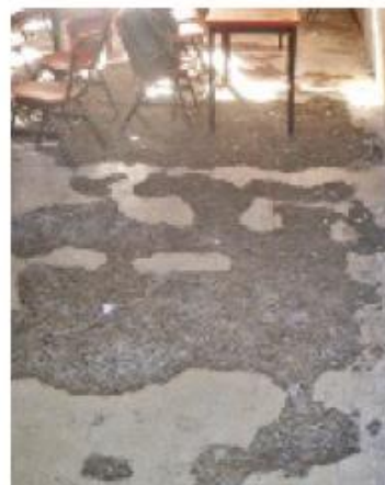
> Alumnos de varios planteles tienen en sus aulas pisos averiados, o incluso de tierra.
