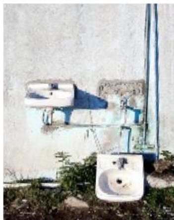
> El mal estado de la infraestructura sanitaria es común en casi todas las escuelas.
