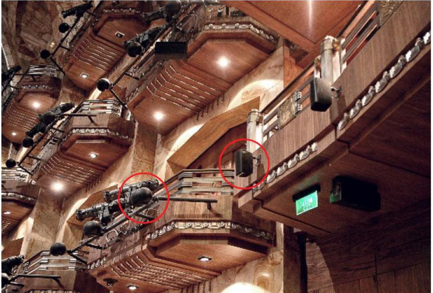
SALA ELECTROACÚSTICA. A lo largo y ancho de la sala, fueron instalados micrófonos y dos tipo de bocinas, tanto para palcos como para balcones. Más que lograr una mejor acústica, la intención es simularla.
