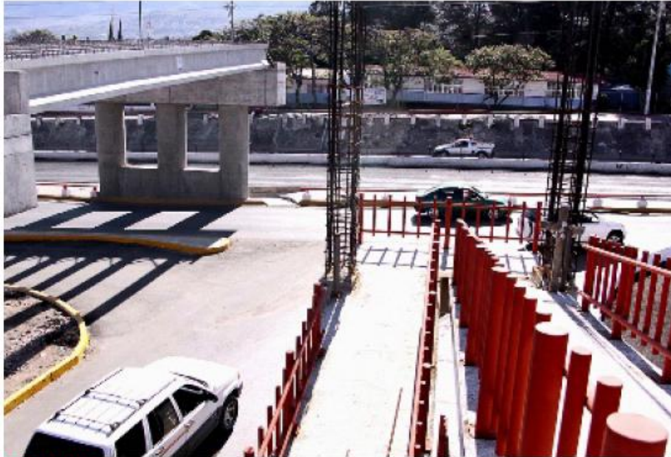
A MEDIAS. El "puente roto" como es conocido por los lugareños, se quedó con un 30 por ciento de avance hasta que se resuelva el trazo que en el proyecto original en donde choca contra un CENDI.
