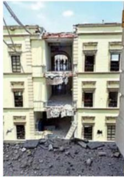
19/S. En una foto subida a redes sociales se ve el lugar donde estaban los puentes colapsados.
