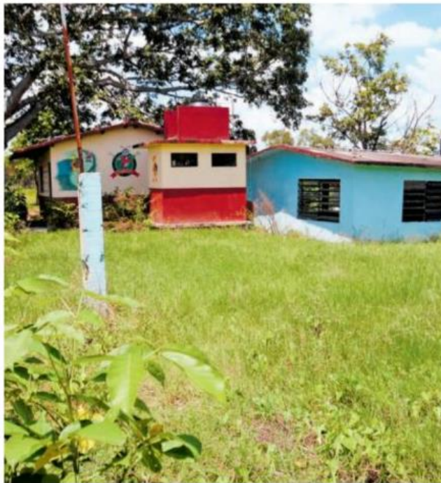
En abandono se encuentran algunas escuelas dañadas en Tabasco/ JAVIER CHÁVEZ
