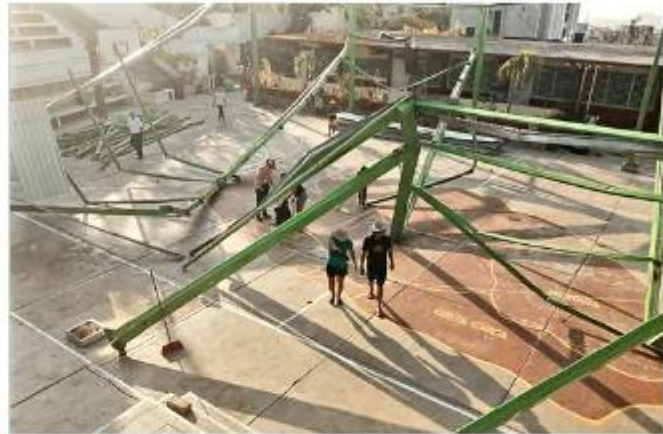
De acuerdo con datos estatales, el huracán "Otis" dejó en Acapulco y Coyuca 404 escuelas con daños.
