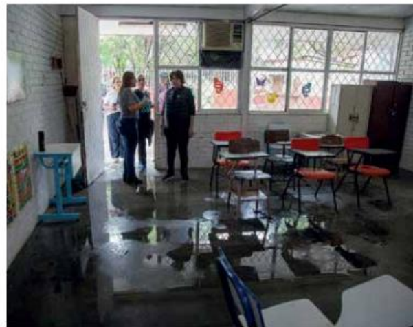
Entre los daños que más se registraron, están las caídas de bardas, falta de electricidad y diferentes goteras.
