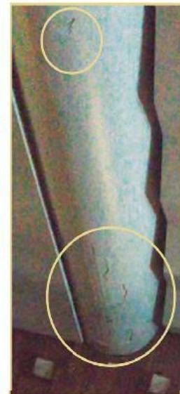
» Algunas de las grietas en el techo del recinto.
