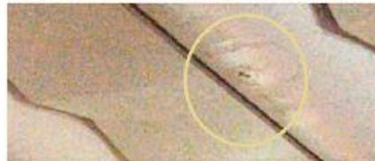
El techo está descascarado, con agujeros y humedad.
