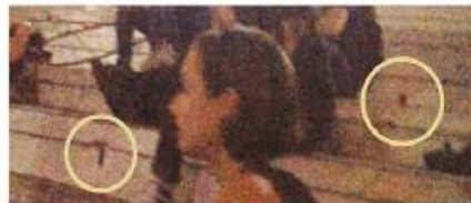
Las gradas, sin butacas, están sucias y agrietadas.
